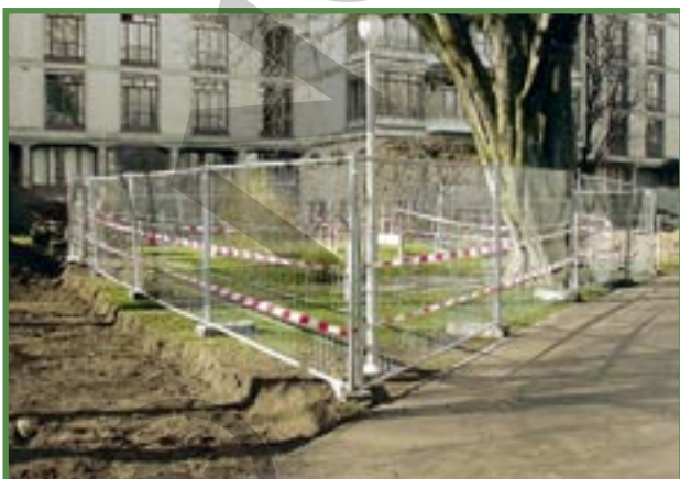
Gedeeltelijke bescherming van stam en boom. Rijplaten op plaatsen waar geen omheining mogelijk is.
